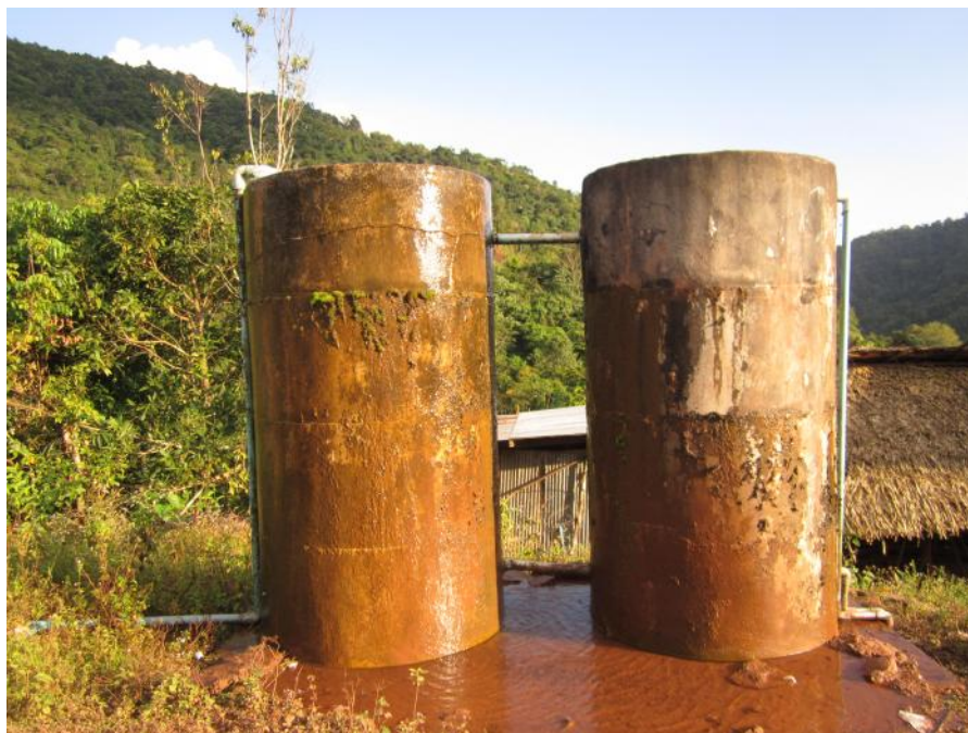
ภาพที่ 3-22 ภาพแสดงถังเก็บน้ำที่ใช้เก็บน้ำเพื่ออุปโภคบริโภคของคนในหมู่บ้านโดยต่อท่อมาจากป่าต้นน้ำมาเก็บไว้ที่ถังเก็บน้ำของหมู่บ้าน
