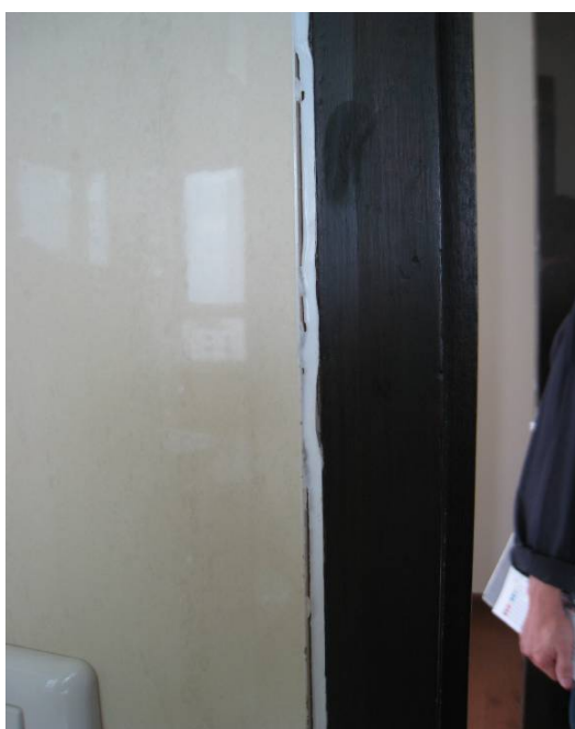
ภาพที่ 5.30 การติดตั้งกรอบหน้าต่างไม่แนบสนิท
