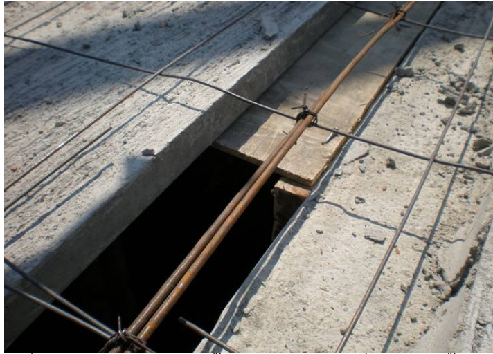
ภาพที่ 5.58 ข้อบกพร่องการตั้งแบบหล่อในส่วนที่ไม่มีแผ่นพื้นสำเร็จ
