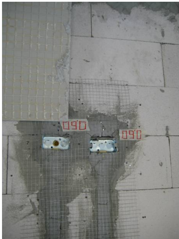
ภาพที่ 5.20 การเสริมตะแกรงกันแตกในบริเวณที่ฝังท่อร้อยสายไฟ
