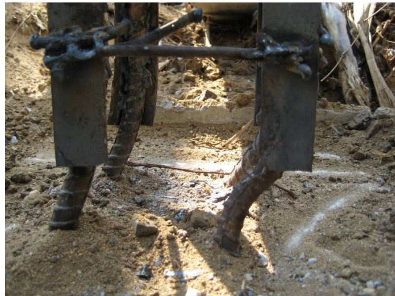
ภาพที่ 5.40 การงอเหล็กเสริมเสาเนื่องจากฐานรากผิดตำแหน่ง
