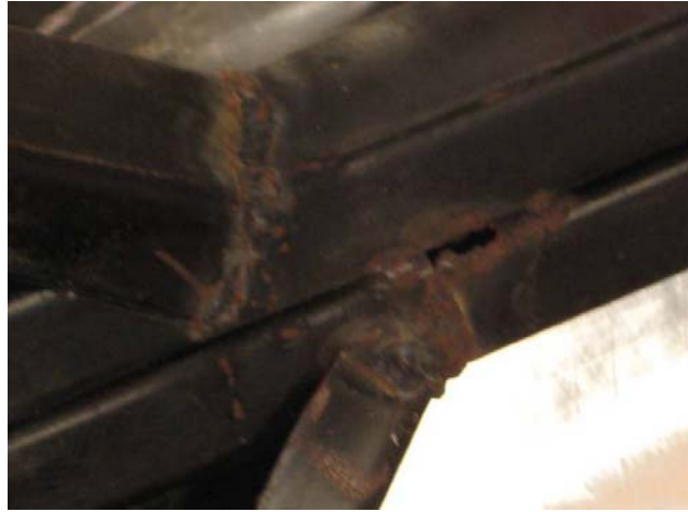
ภาพที่ 5.65 ข้อบกพร่องโครงสร้างหลังคาและรอยเชื่อมไม่ได้มาตรฐาน
