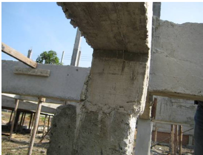
ภาพที่ 5.38 การแก้ไขปรับแก้ตำแหน่งเสาตอม่อด้วยการพอกเสา
