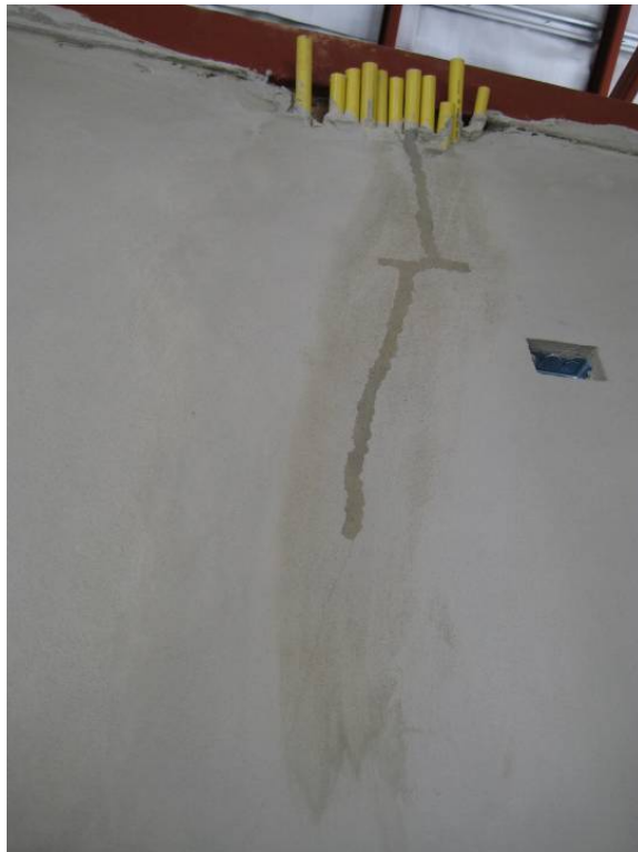
ภาพที่ 5.84 รอยรั่วที่เกิดบริเวณการฝังท่อระบบไฟฟ้า
