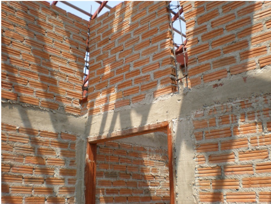
ภาพที่ 5.17 ขาดการเสียบเหล็กเสริมกันแตกเพื่อยึดผนังกับเสาและกำแพง
