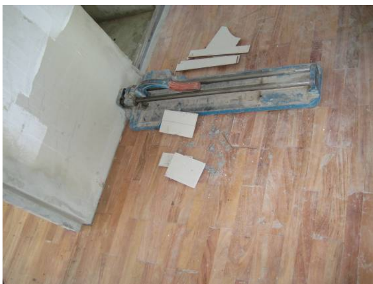
ภาพที่ 5.96 รอยขีดข่วนบนงานพื้นลามิเนตเกิดความเสียหาย
