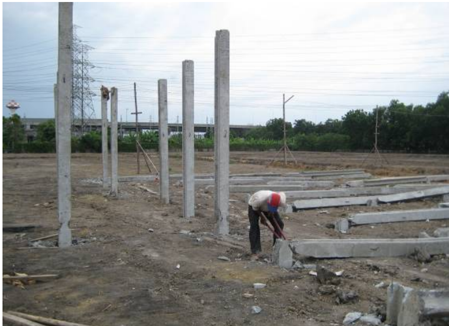
ภาพที่ 5.42 เสาเข็มตอกไม่ลงเนื่องจากไม่ทราบสภาพชั้นดิน
