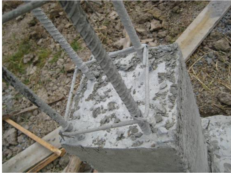
ภาพที่ 5.39 ข้อบกพร่องเหล็กเสริมเสาล้มเอียงเนื่องจากขาดการรองลูกปูน
