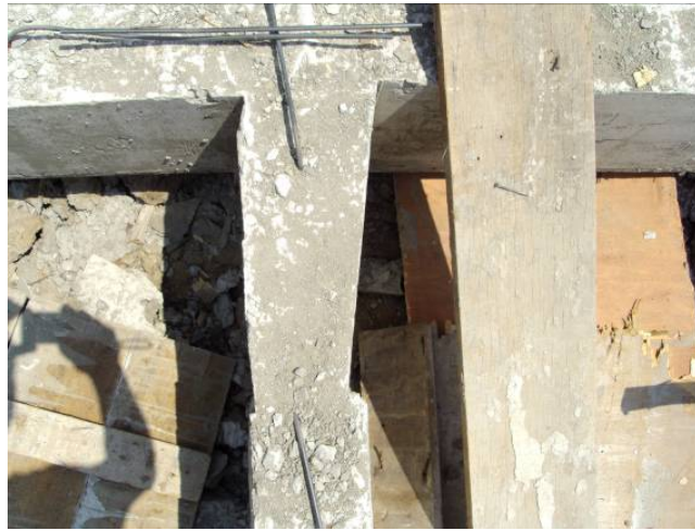
ภาพที่ 5.47 ข้อบกพร่องขนาดพื้นที่หน้าตัดคาน เนื่องจากปัญหาในขั้นตอนการตั้งแบบหล่อ
