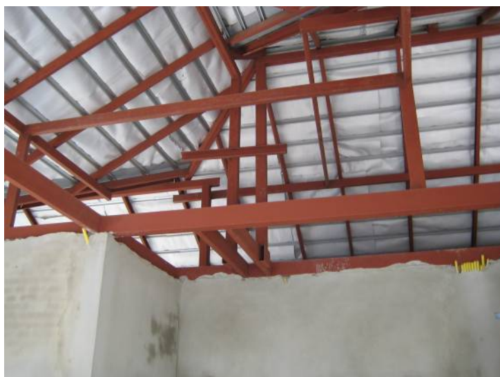
ภาพที่ 5.64 ข้อบกพร่องโครงสร้างหลังคาไม่ได้มาตรฐาน ขาดการออกแบบทางโครงสร้าง
