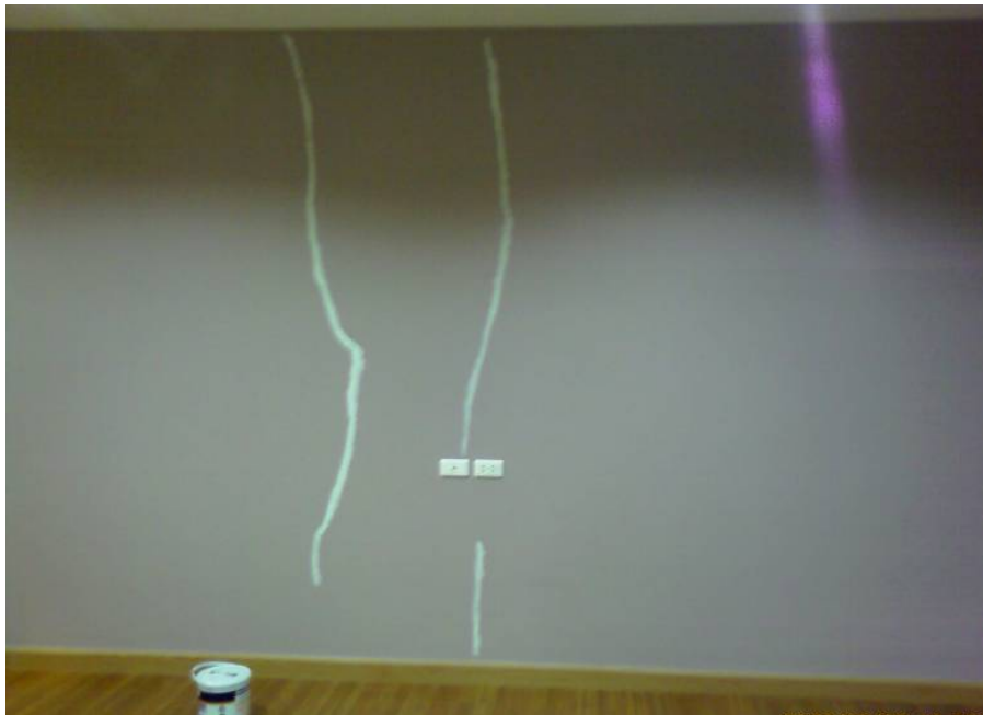
ภาพที่ 5.19 รอยร้าวเนื่องจากขาดการเสริมตะแกรงกันแตกตามแนวท่อร้อยสายไฟ
