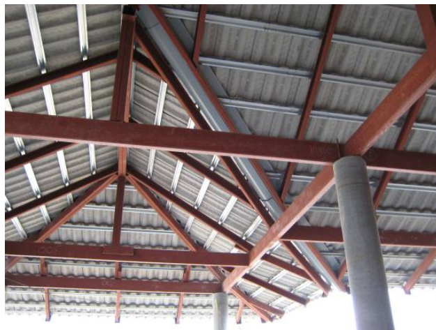
ภาพที่ 5.72 ข้อบกพร่องระยะซ้อนทับ Flashing น้อยเกินไป ทำให้ Flashing ไม่แนบสนิท
