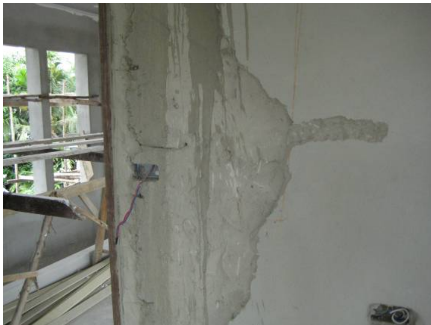
ภาพที่ 5.18 การสกัดเพื่อทำการแก้ไขรอยร้าวเนื่องจากขาดการเสริมตะแกรงกันแตก
