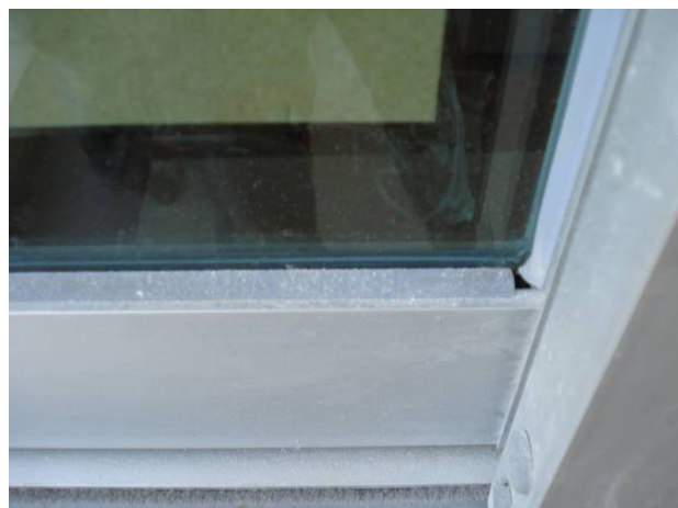
ภาพที่ 5.33 ข้อบกพร่องบานอลูมิเนียมที่ทำการติดตั้ง
