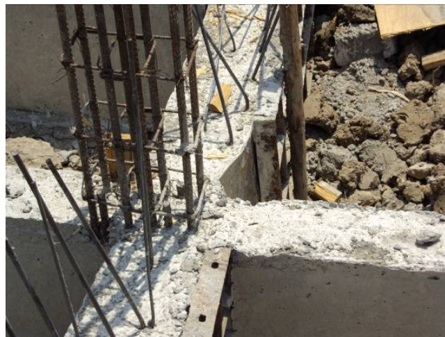
ภาพที่ 5.48 ข้อบกพร่องตำแหน่งคานไม่ตรงกับเสา
