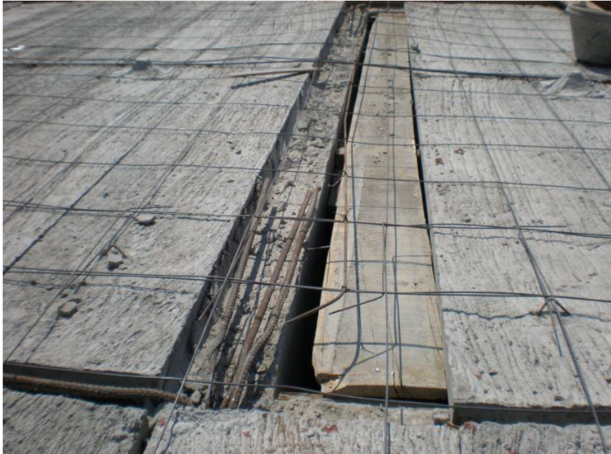
ภาพที่ 5.60 การเสริมเหล็กตะแกรงกันแตกไม่ตรงกับขนาดที่กำหนด
