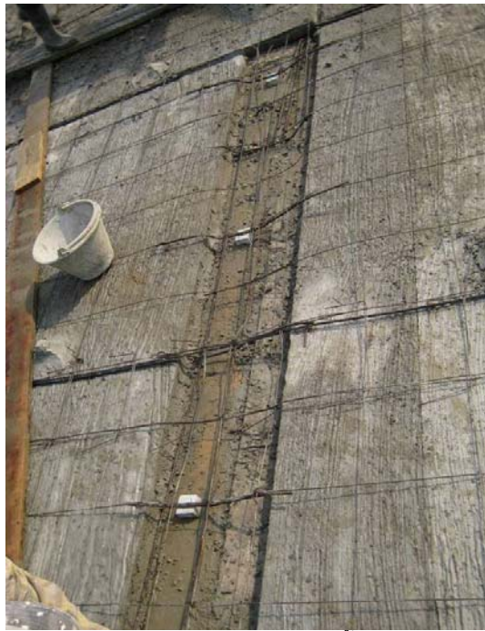
ภาพที่ 5.56 ซ็อบกพรวงระยะพาดแผ่นพื้นสำเร็จที่น้อยเกินไป
