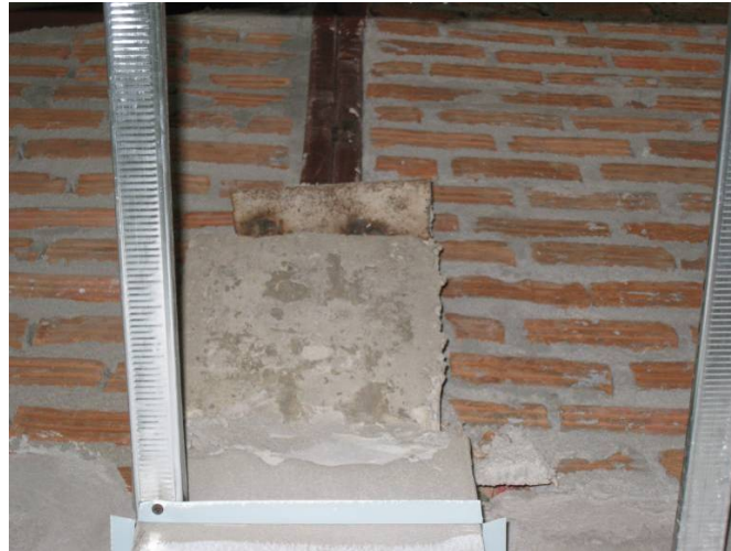
ภาพที่ 5.68 ข้อบกพร่องเสาผิดตำแหน่งทำให้ไม่ตรงกับโครงสร้างหลังคา
