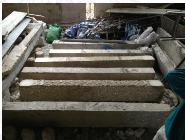
รูปที่ 4-18 ความเสียหายของคานคอนกรีตเสริมเหล็กจากการเผาไฟที่ระดับความ รุนแรงของไฟต่างๆ
