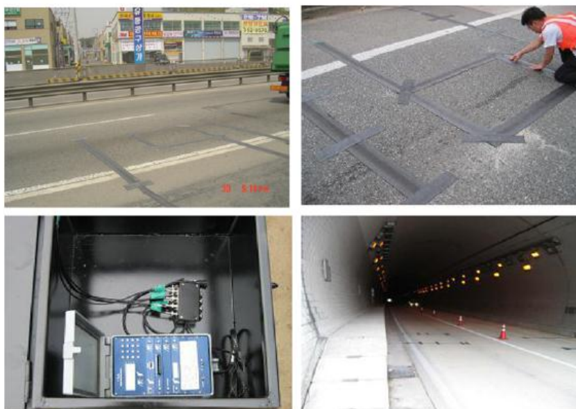
รูปที่ 1.2 การติดตั้งเซนเซอร์เพื่อวัดน้ำหนักรถบรรทุก (Hwang, Nguyen et al. ,2012)
