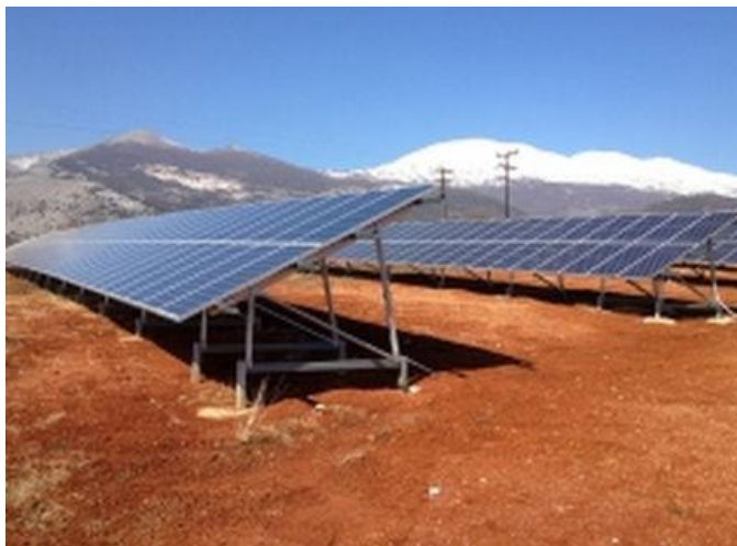
ภาพที่ 3.1 การติดตั้งอาร์เรย์เซลล์แสงอาทิตย์แบบอยู่กับที่
