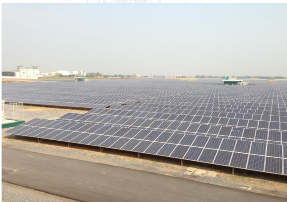
ภาพที่ 7.8 โรงไฟฟ้าของระบบทดสอบระบบผลิตไฟฟ้าเซลล์แสงอาทิตย์ ระบบที่ 2
