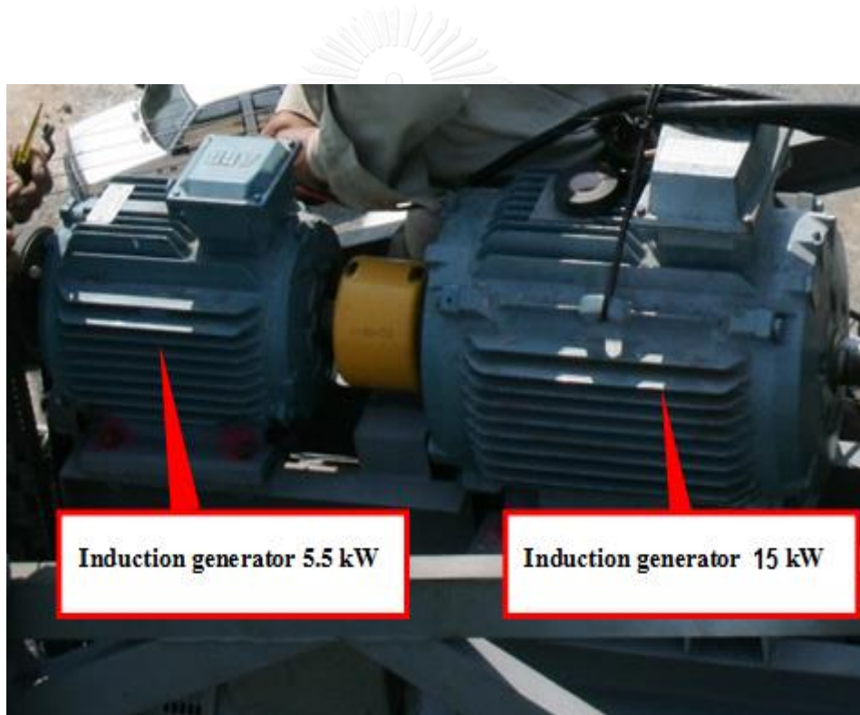
ภาพที่ 4.32 การติดตั้งเครื่องกำเนิดไฟฟ้า Induction generator ขนาด 5.5 กิโลวัตต์ และ 15 กิโลวัตต์
