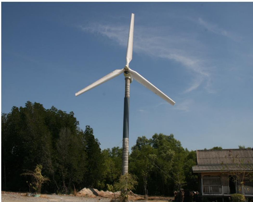
ภาพที่ 4.35 กังหันลม 3 ใบพัดที่วัดหงส์ทอง จังหวัดฉะเชิงเทรา ที่ได้ติดตั้งเรียบร้อยแล้ว
