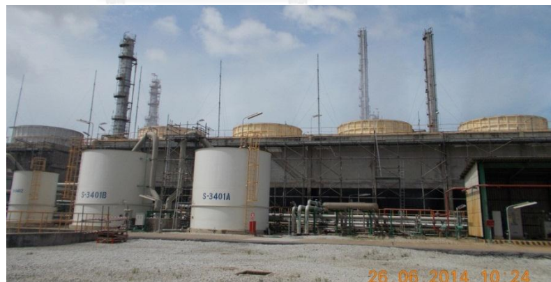
รูปที่ 3. 6 ตัวอย่างอุปกรณ์ระบบหล่อเย็น (Cooling system)
