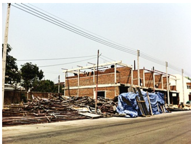
ภาพที่ 4.26แสดงลักษณะงานก่อสร้างของโครงการบ้านสินทรัพย์(ต่อ)
