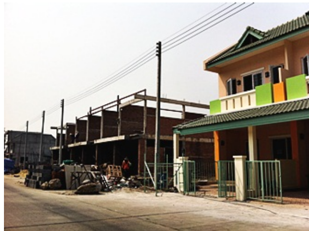
ภาพที่ 4.25แสดงลักษณะงานก่อสร้างของโครงการบ้านสินทรัพย์
