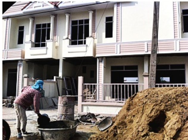
ภาพที่ 4.36 แสดงลักษณะงานก่อสร้างของโครงการบ้านมั่นคงกานต์
