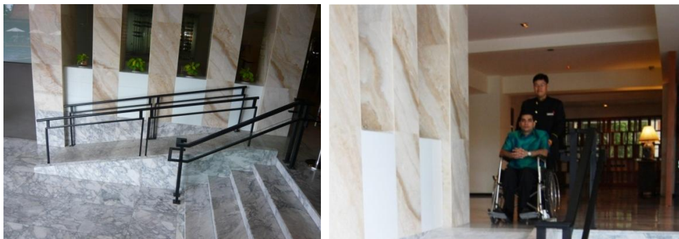
ภาพที่ 5.7 ตำแหน่งทางลาดเชื่อมเข้าสู่พื้นที่ห้องอาหารของโรงแรมรามาดาฯ
