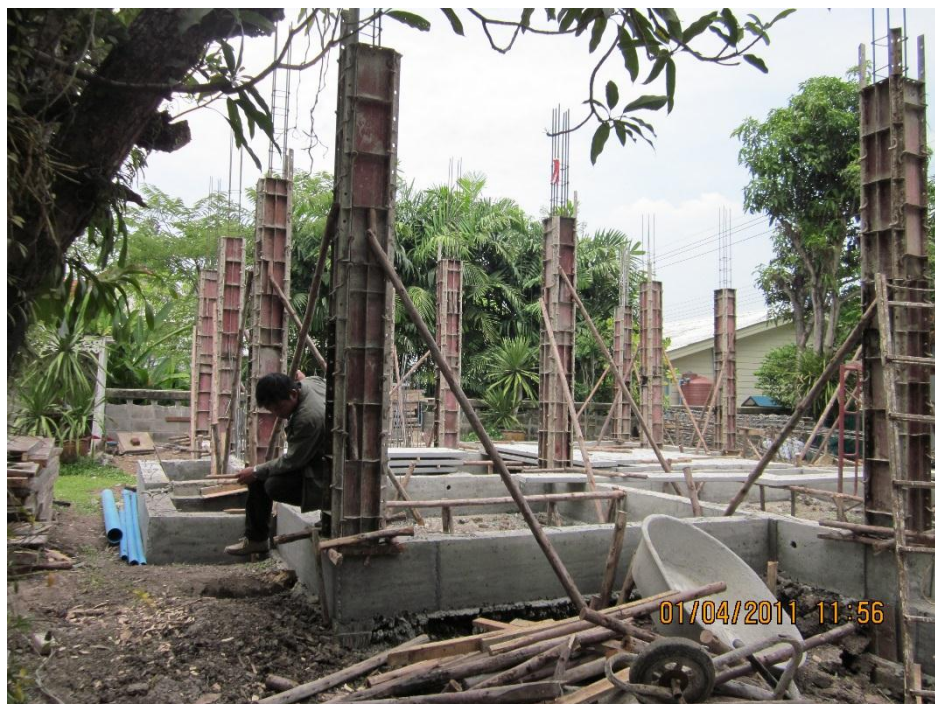
ภาพที่ 1.7 แสดงการตั้งไม้แบบเตรียมงานเทคอนกรีตเสา อาคารทั่วไป
