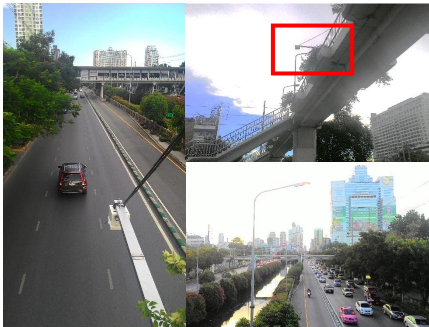
รูปที่ 3.20 : ตำแหน่งในการติดตั้งตัวรับรู้ประเภทบลูทูธบนสะพานลอยบริเวณถนนราธิวาสราชนครินทร์
