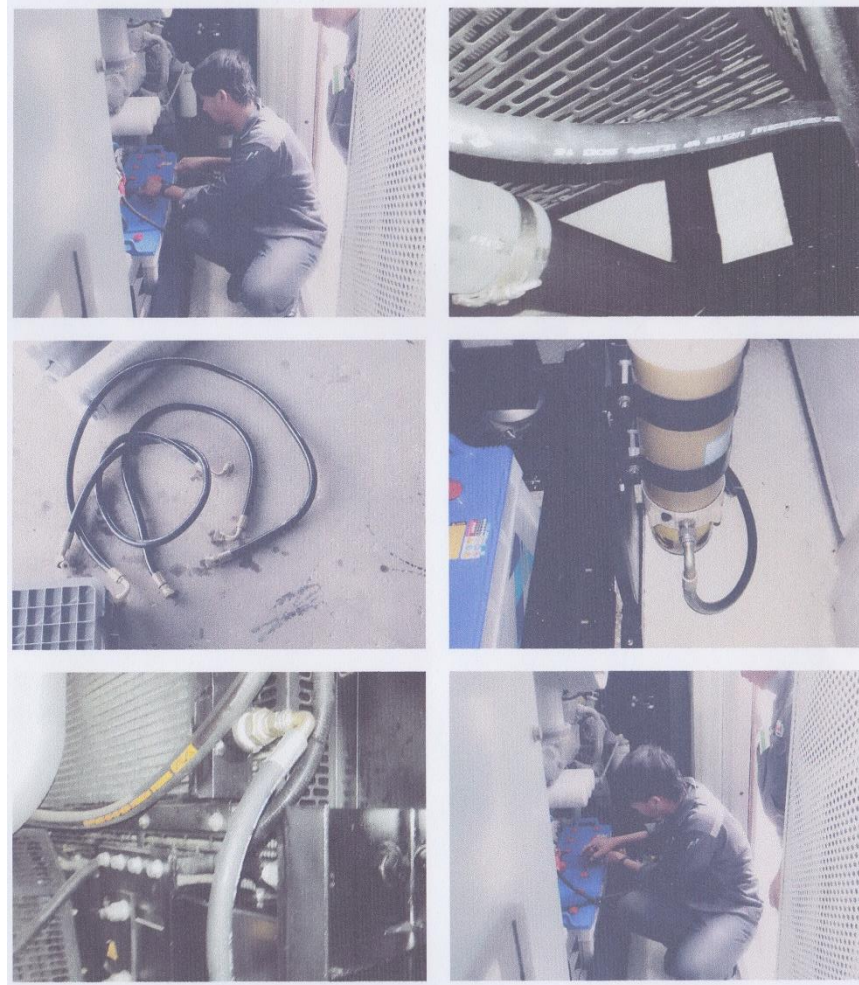
รูปที่ 6.15 ท่อเชื้อเพลิงเสื่อมสภาพ
