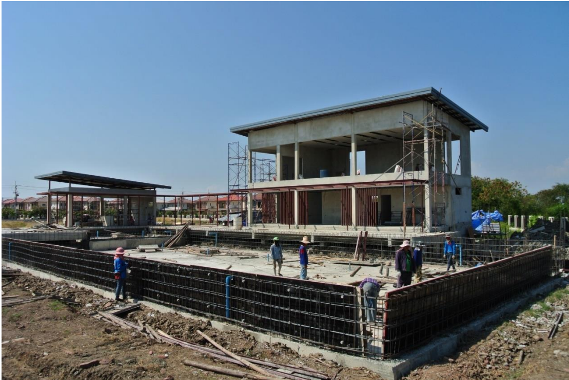
ภาพที่ 4. 41 สโมสรและสระว่ายน้ำ (อยู่ระหว่างการก่อสร้าง) โดยสองโครงการใช้ร่วมกัน
