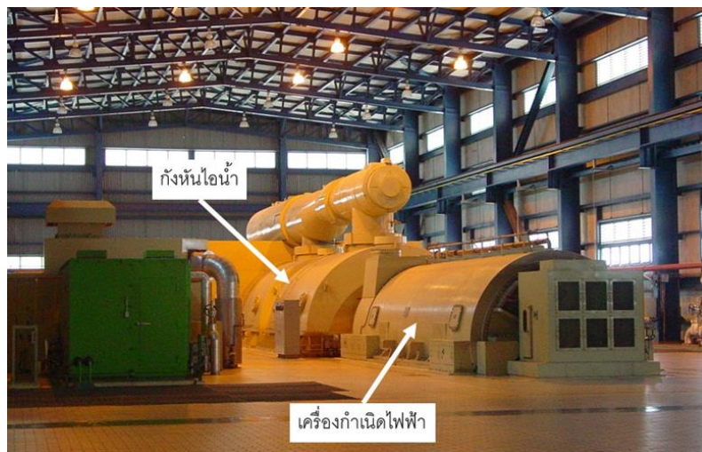
รูปที่ 9 เครื่องกำเนิดไฟฟ้า
