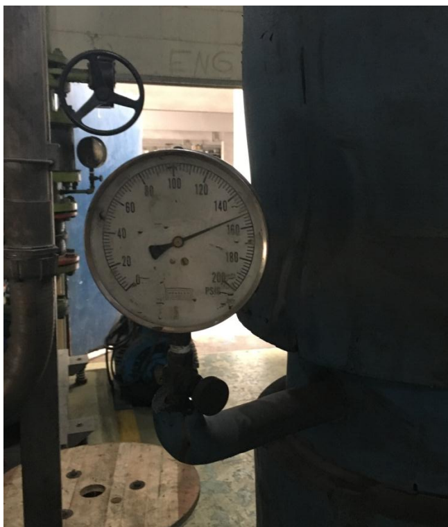
รูปที่ ข.3 การตรวจวัดความดันด้านจ่ายของเครื่องสูบน้ำเย็น
