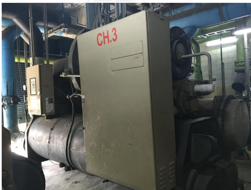
รูปที่ ข.4 เครื่องทำน้ำเย็นที่ทำการตรวจวัด
