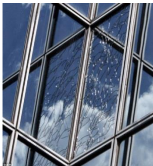
รูปที่ 1.16 การแตกร้าวของกระจกในผนังภายนอกของอาคารจากแผ่นดินไหวขนาด 5.9 ในรัฐเวสต์เวอร์จิเนีย เมื่อปี 2010 ( http://www.dailymail.co.uk/news )
