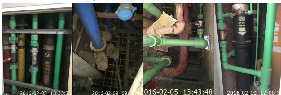
รูปที่ 33 มาตรฐานการติดตั้งท่อที่ไม่ได้ดำเนินการ
