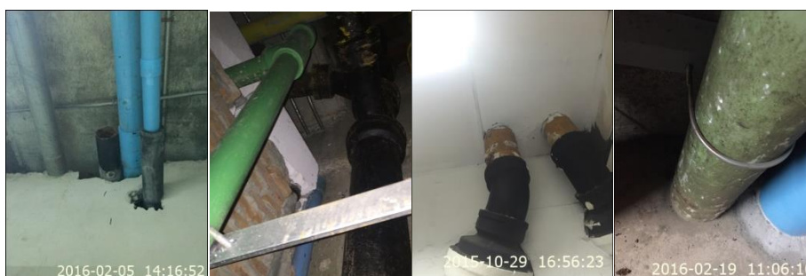
รูปที่ 34 มาตรฐานการติดตั้งท่อที่ไม่ได้ดำเนินการ
