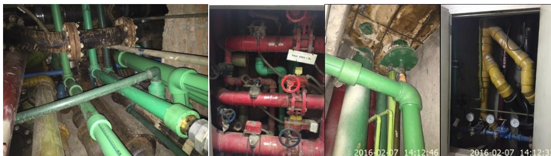
รูปที่ 32 มาตรฐานการติดตั้งท่อที่ไม่ได้ดำเนินการ
