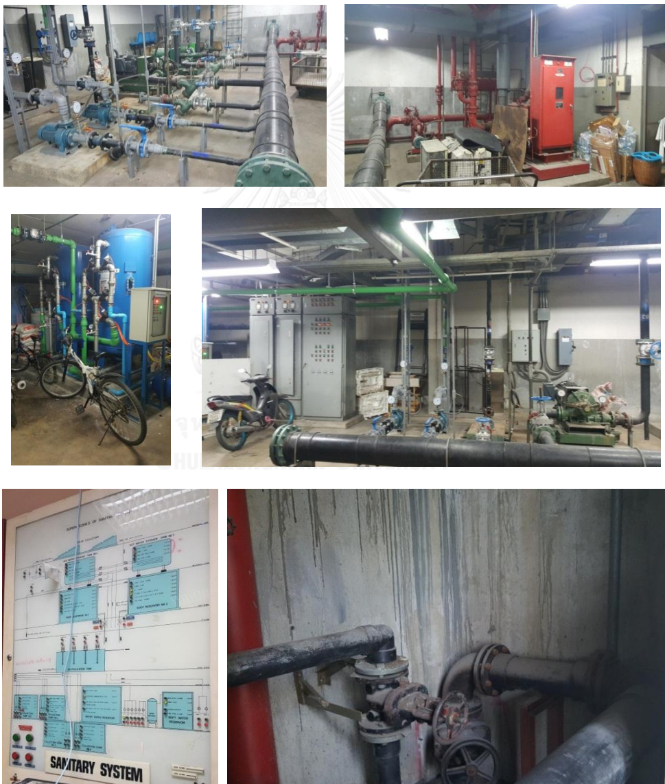
ภาพที่ 8 ห้องเครื่องระบบสุขาภิบาลและดับเพลิง ป้องกันอัคคีภัย อาคาร ภปร
