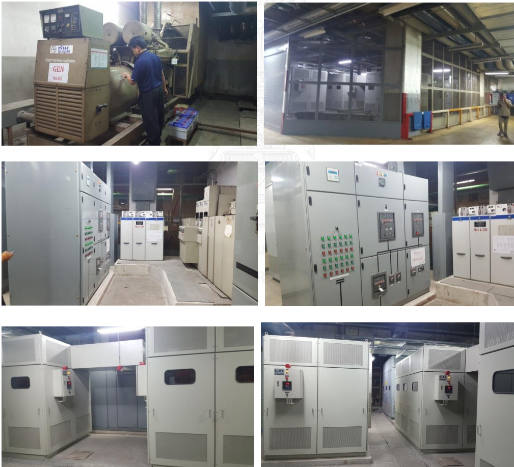
ภาพที่ 7 ห้องเครื่องระบบไฟฟ้ากำลังและไฟฟ้าสำรองอาคาร ภปร
