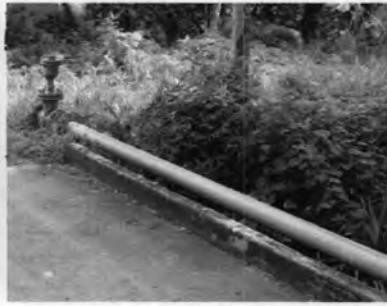
ระบบท่อประปาส่งน้ำในชุมชน
