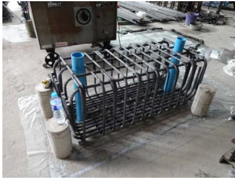
รูปที่ 4.6 ประกอบเหล็กของฐานให้ตรงตำแหน่งที่ตีเส้นไว้เพื่อความแม่นยำในการประกอบเหล็กเสริมตามยาวและการตั้งแบบหล่อคอนกรีต
