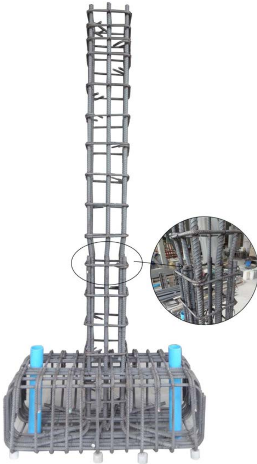
รูปที่ 4.8 ตัวอย่างเสา C-SP-100 เมื่อทำการประกอบเหล็กเสริมเสร็จสิ้น
