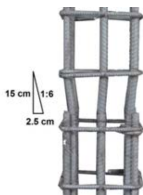
รูปที่ 4.1 การตัดให้มีความลาดเอียงของเหล็กเสริมส่วนที่ตัดเยื้องกัน เมื่อเทียบกับแกนของเสา
