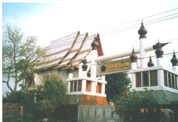
ภาพที่ 3.20 วัดพายัพและพระอุโบสถหลังใหม่ที่กำลังก่อสร้าง
