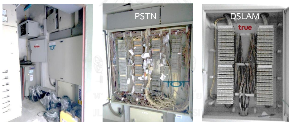
รูปที่ 6.7 ระบบ Internet ภายในห้องเครื่องไฟฟ้า
