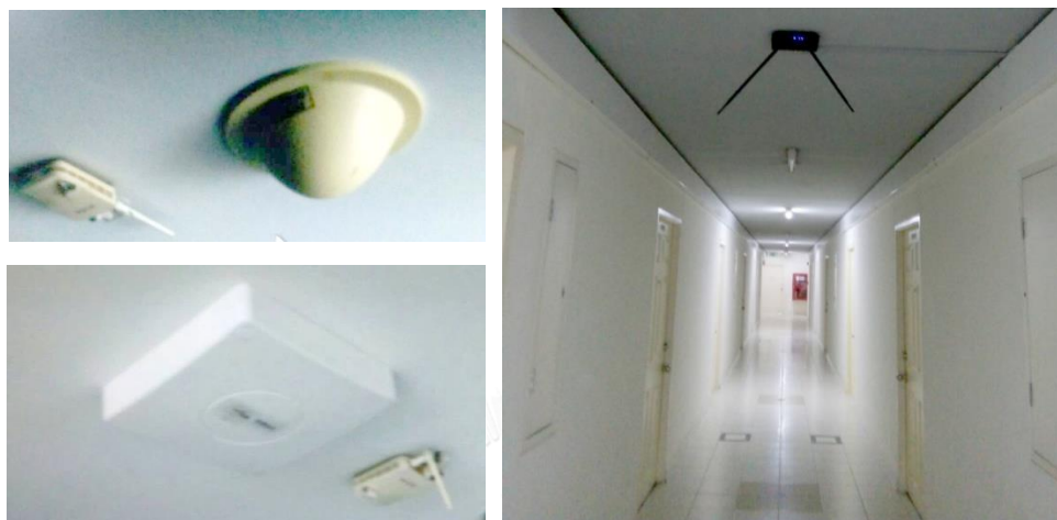
รูปที่ 6.8 Accesspoint ของอาคาร High Rise
