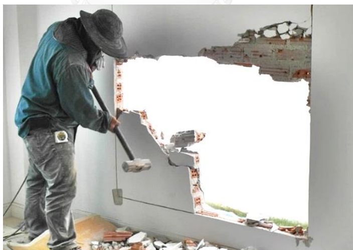
รูปที่ 2.19 การรื้อถอนอาคารโดยใช้แรงงานคน 3
