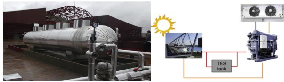
ภาพที่ 2.25 ลักษณะแทงค์บรรจ PCM ในระบบ Solar cooling (ซ้าย)
