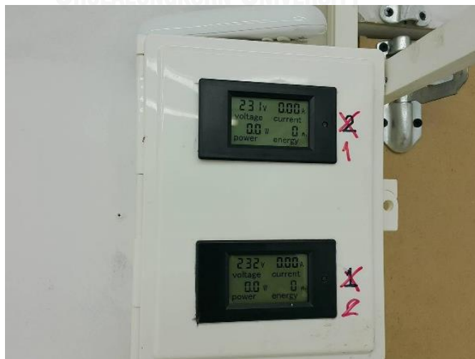
ภาพที่ 23 เครื่อง Digital Energy Monitor 2
