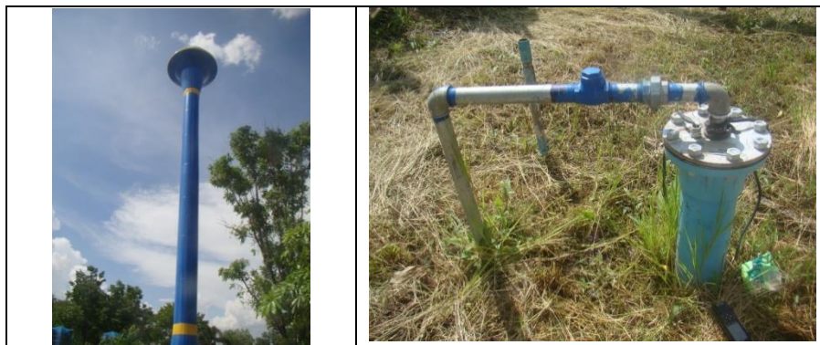
รูปที่ ภาคผนวก ข - 23 บ่อบาดาลสถานีที่ 23
