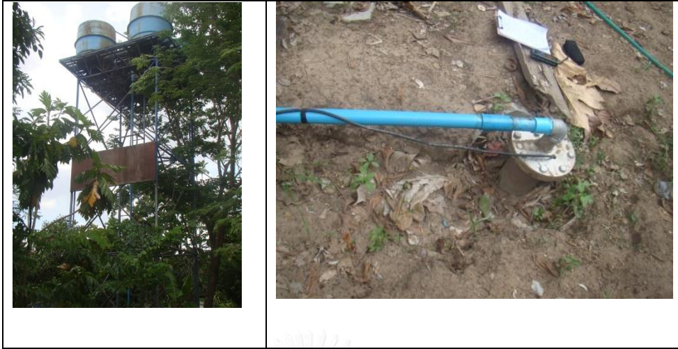
รูปที่ ภาคผนวก ข - 46 บ่อบาดาลสถานีที่ 46
