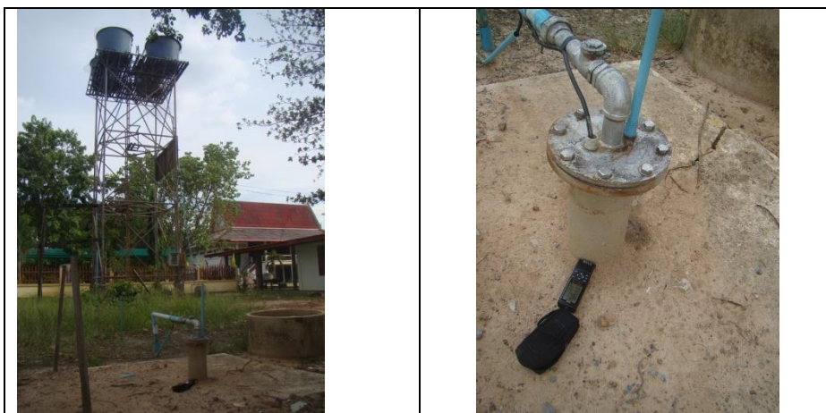
รูปที่ ภาคผนวก ข - 17 บ่อบาดาลสถานีที่ 17
