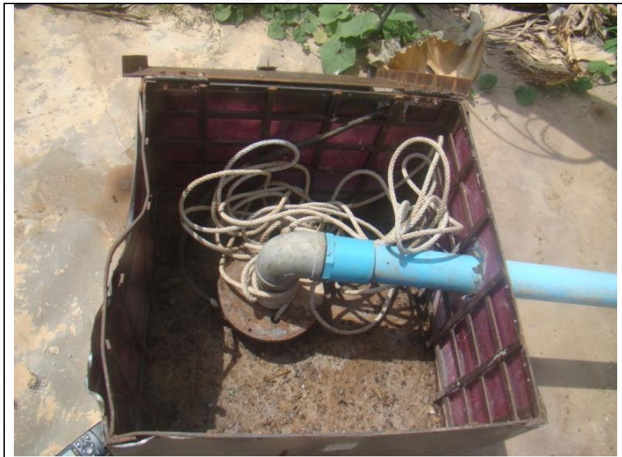
รูปที่ ภาคผนวก ข - 4 บ่อบาดาลสถานีที่ 4
