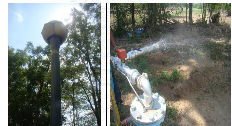
รูปที่ ภาคผนวก ข - 45 บ่อบาดาลสถานีที่ 45
