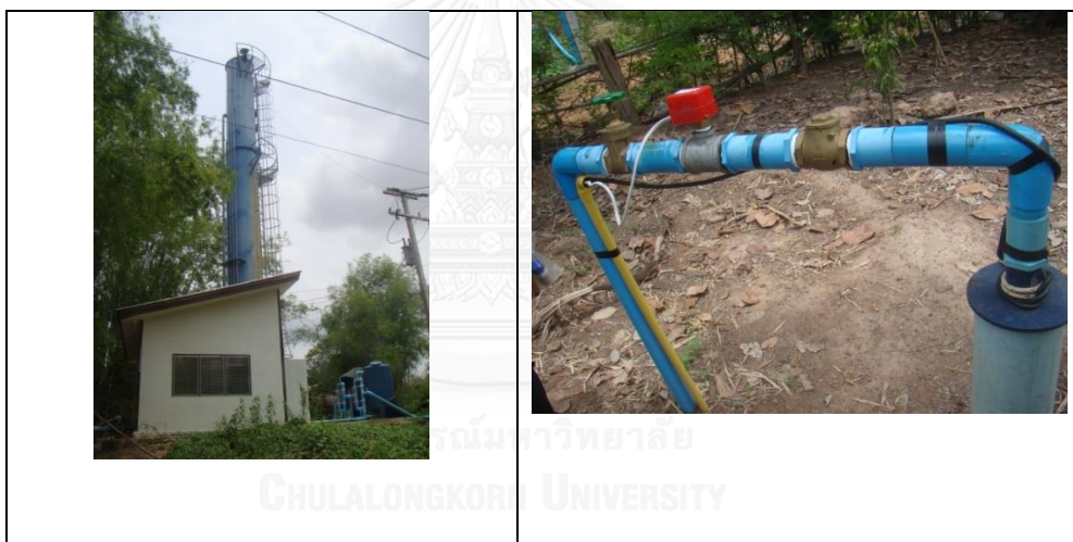
รูปที่ ภาคผนวก ข - 42 บ่อบาดาลสถานีที่ 42
