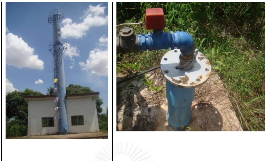
รูปที่ ภาคผนวก ข - 33 บ่อบาดาลสถานีที่ 33
