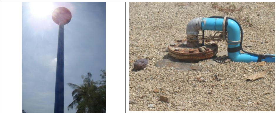
รูปที่ ภาคผนวก ข - 7 บ่อบาดาลสถานีที่ 7
