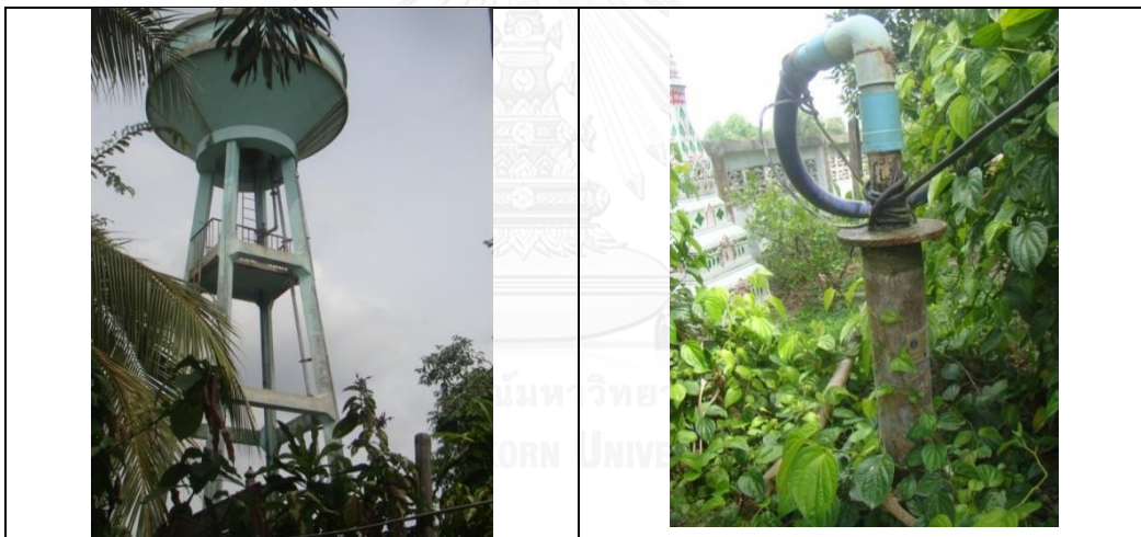
รูปที่ ภาคผนวก ข - 36 บ่อบาดาลสถานีที่ 36
