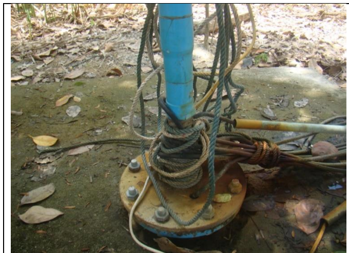
รูปที่ ภาคผนวก ข - 41 บ่อบาดาลสถานีที่ 41
