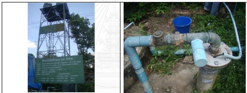
รูปที่ ภาคผนวก ข - 6 บ่อบาดาลสถานีที่ 6
