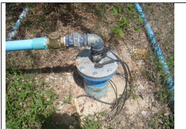
รูปที่ ภาคผนวก ข - 34 บ่อบาดาลสถานีที่ 34
