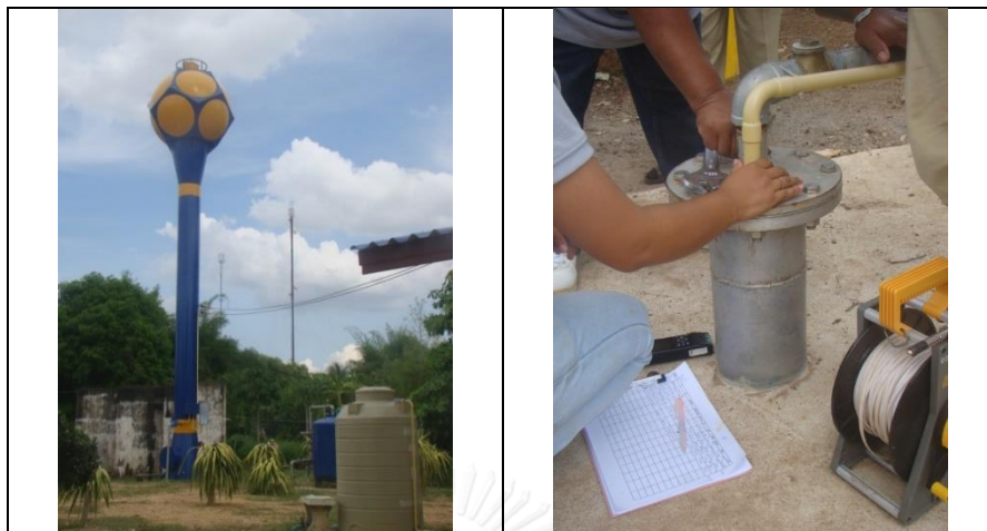
รูปที่ ภาคผนวก ข - 1 บ่อบาดาลสถานีที่ 1
