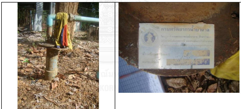
รูปที่ ภาคผนวก ข - 2 บ่อบาดาลสถานีที่ 2
