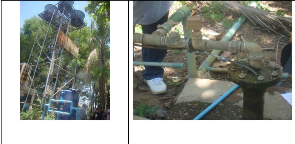
รูปที่ ภาคผนวก ข - 27 บ่อบาดาลสถานีที่ 27
