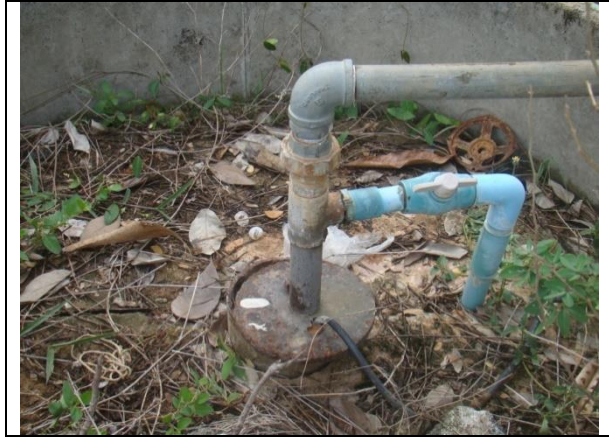
รูปที่ ภาคผนวก ข - 19 บ่อบาดาลสถานีที่ 19
