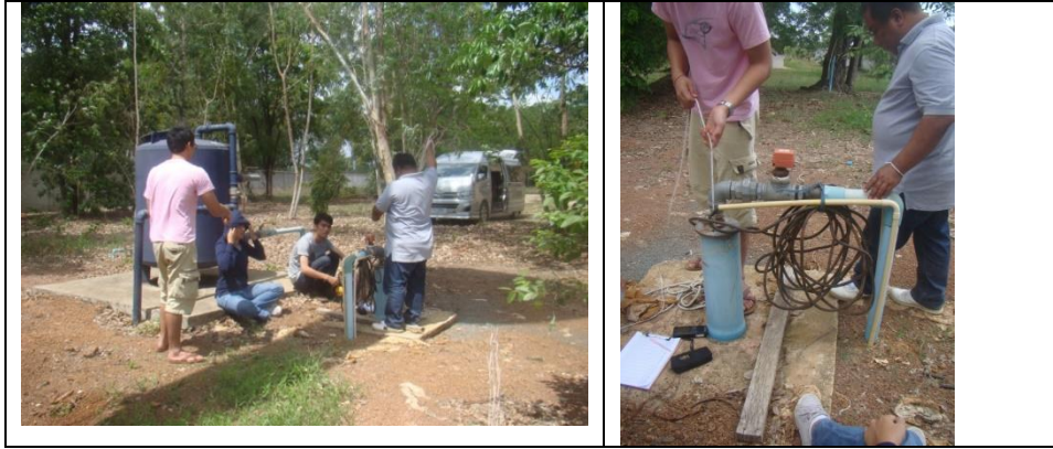
รูปที่ ภาคผนวก ข - 3 บ่อบาดาลสถานีที่ 3
