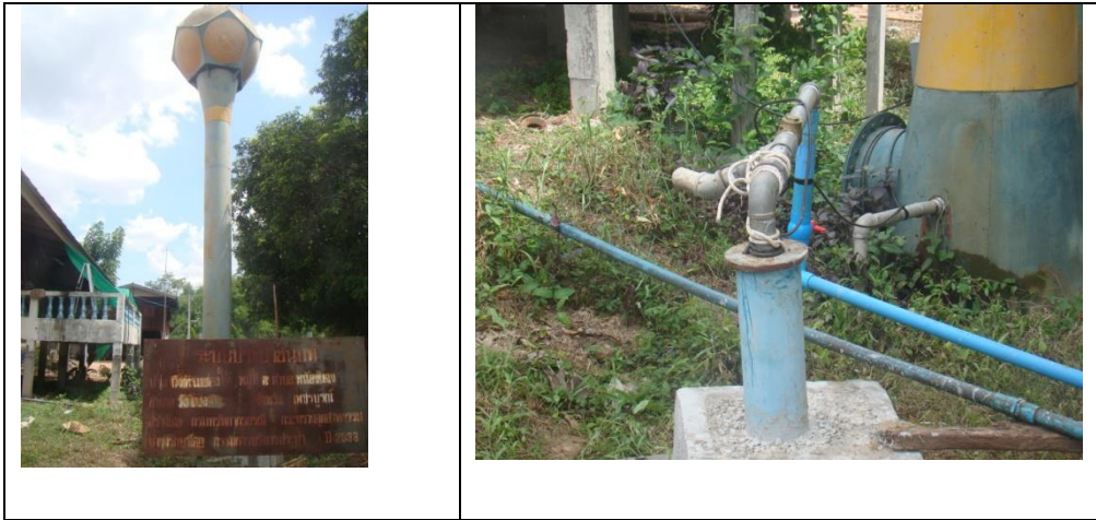
รูปที่ ภาคผนวก ข -35 บ่อบาดาลสถานีที่ 35
