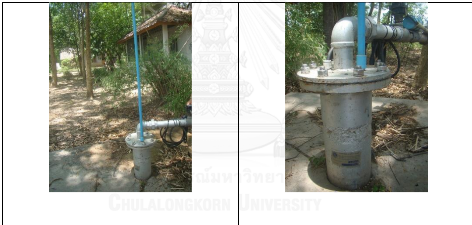
รูปที่ ภาคผนวก ข - 28 บ่อบาดาลสถานีที่ 28
