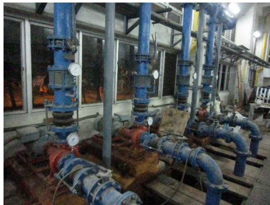
รูปที่ ก-1 เครื่องสูบน้ำ
