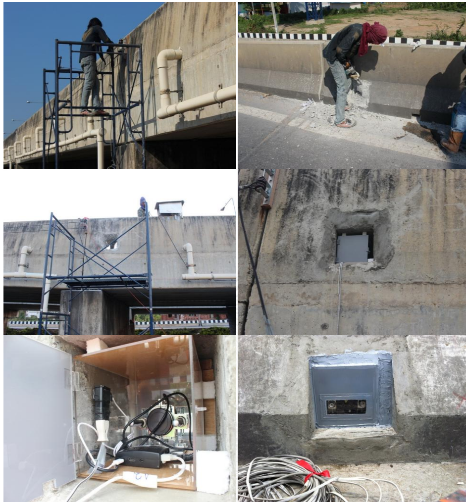
รูปที่ 3.16 ภาพแสดงการติดตั้งอุปกรณ์ตรวจจับเพลลาที่สะพานทดสอบ
