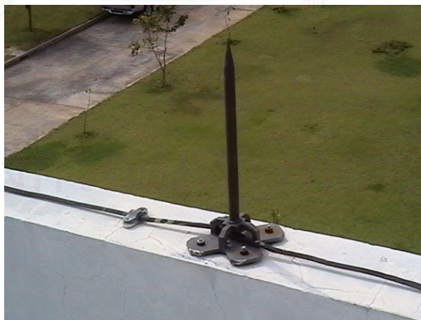
ภาพที่ 3.26 แสดงสายล่อฟ้าบนชั้นหลังคา
