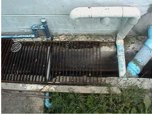
ภาพที่ 3.34 แสดงที่ระบายน้ำรอบอาคาร
