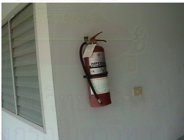
ภาพที่ 3.18 แสดงถังดับเพลิง
