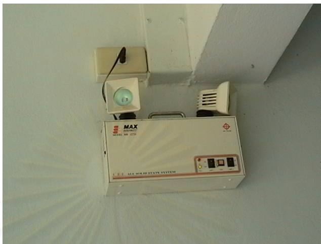
ภาพที่ 3.17 แสดงเครื่องสำรองไฟฟ้าฉุกเฉิน
