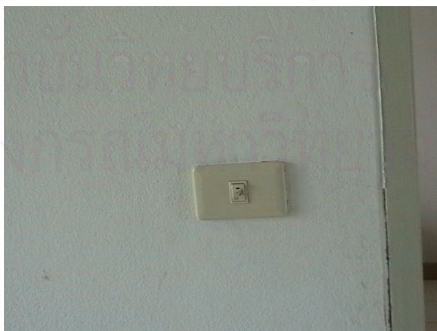
ภาพที่ 3.13 แสดงการเดินสายไฟแบบฝังและซ่อนในผนัง
