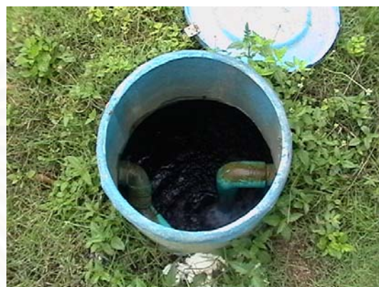
ภาพที่ 3.30 แสดงถังเก็บน้ำประปาใต้ดิน
