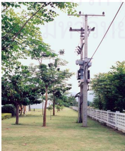
ภาพที่ 3.28 แสดงหม้อแปลงไฟฟ้าภายในศูนย์บ้านพักฯ
