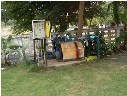
ภาพที่ 3.43 แสดงเครื่องปั้มน้ำเข้าสู่ sprinkler
