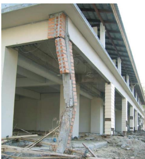
รูปที่ 1.2 ความเสียหายของเสาอาคาร เนื่องจากแรงกระแทกจากวัตถุที่ไหลมากับน้ำ (debris) (Lukkunaprasit and Ruangrassamee, 2007)
