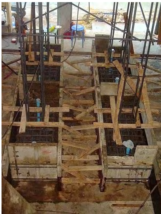
รูปที่ 4.8 การผูกเหล็กและการติดตั้งค้ำยันของแบบฐานราก
