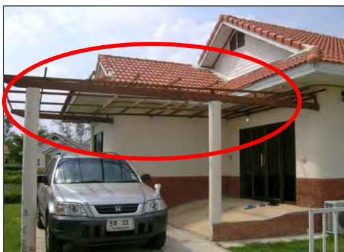
ภาพที่ 5.3 แสดงตัวอย่างบ้านที่โครงการยังไม่ดำเนินการติดหลังคารถไฟให้เรียบร้อย ทั้งที่บ้านได้ส่งมอบกับผู้ซื้อเรียบร้อยแล้ว (D 25)
