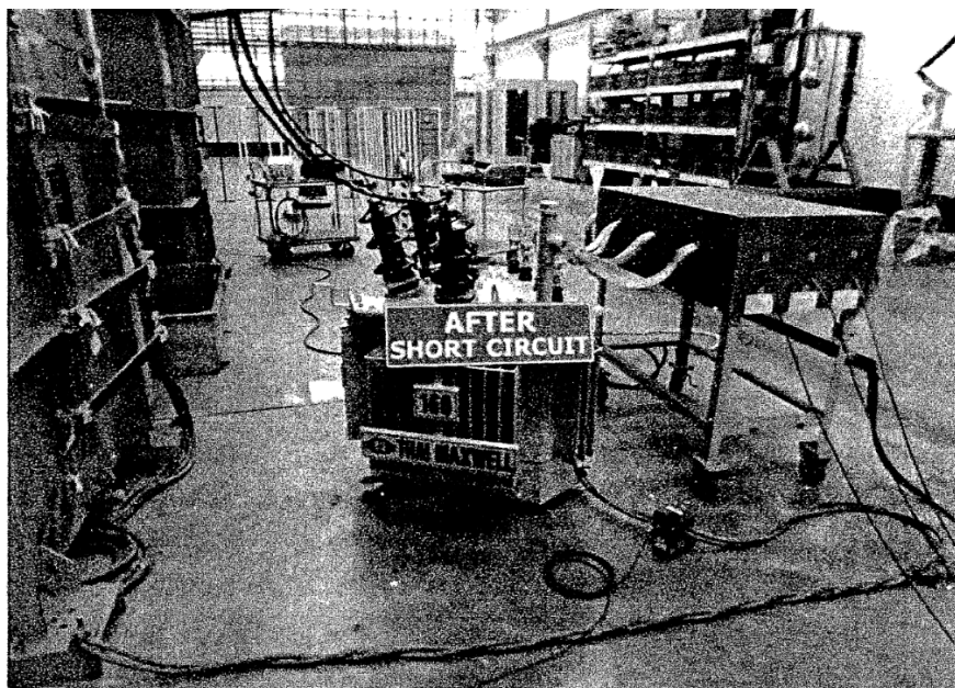
รูปที่ 3.18 ภาพถ่ายหม้อแปลงไฟฟ้าหลังจากทำการทดสอบฯ [8]
