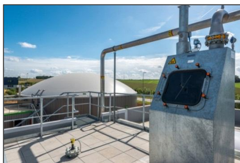
รูปที่ 2-8 โรงงานผลิตไฟฟ้าชีวภาพจากชีวมวลของประเทศเบลเยียม (German Energy Agency, 2012)
