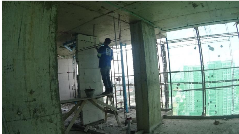
รูปที่ 4.18 การวางเหล็กเสริมสำหรับการก่อสร้างเสาเอ็นและทับหลังชนิดหล่อในที่ (อิฐมวลเบา)
