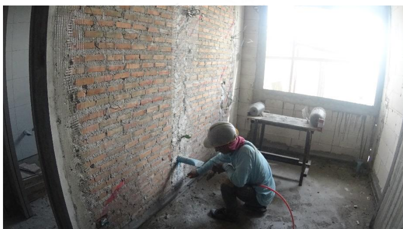
รูปที่ 4.22 การติดตาข่ายเหล็ก (อิฐมวลเบา)
