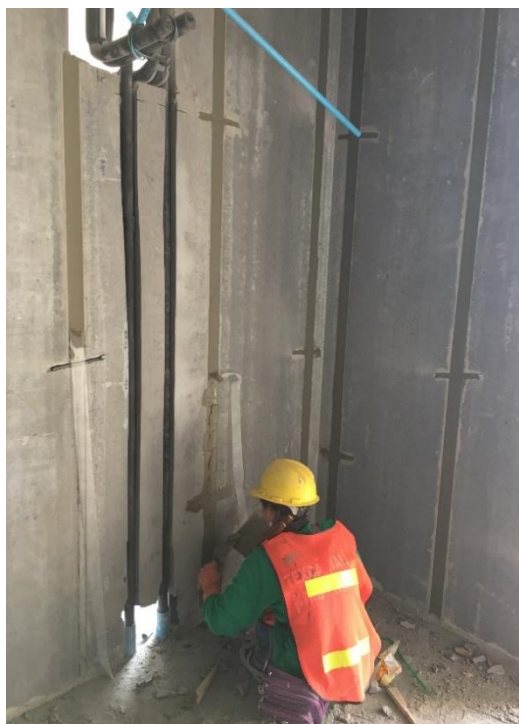
รูปที่ 5.26 การใส่เหล็กเชยคียในในกรณีศึกษาเสริมที่ 1 กระบวนการก่อสร้างผนังคอนกรีตมวลเบา
