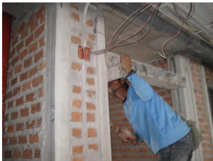
รูปที่ 4.36 การก่อสร้างเสาเอ็นและทับหลัง (อิฐมอญ)
