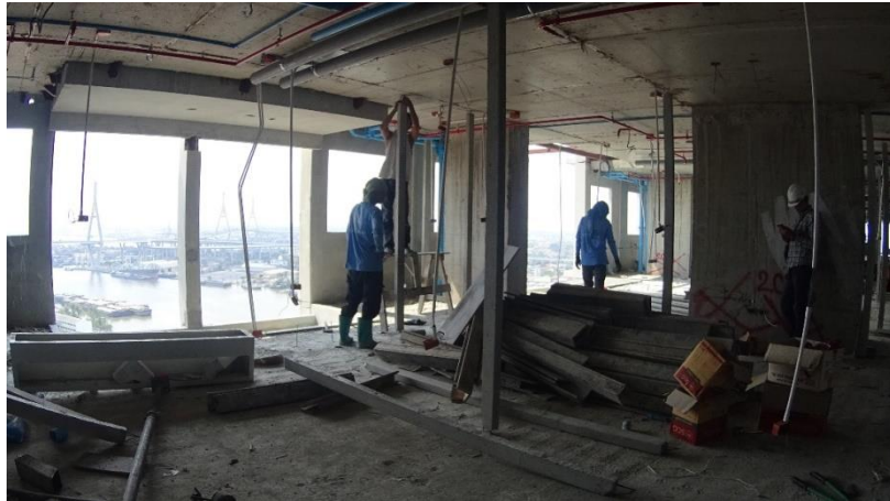
รูปที่ 4.29 การติดตั้งเสาเอ็นสำเร็จรูป (อิฐมวลเบา)
