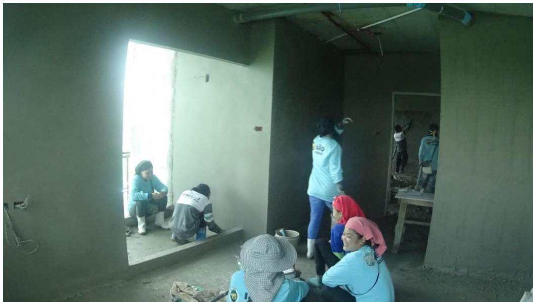
รูปที่ 5.7 (ก) การหยุดพักของคณงานเนื่องจากการจ้างแรงงานในสัดส่วนที่ไม่สมดุลกับงาน
