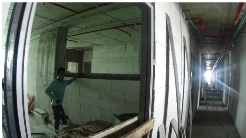
รูปที่ 4.21 การก่อสร้างเสาเอ็นและทับหลังชนิดหล่อในที่ (อิฐมวลเบา)
