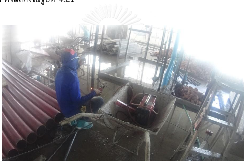
รูปที่ 4.16 การติดตั้งเสาเอ็นสำเร็จรูป (อิฐมวลเบา)
