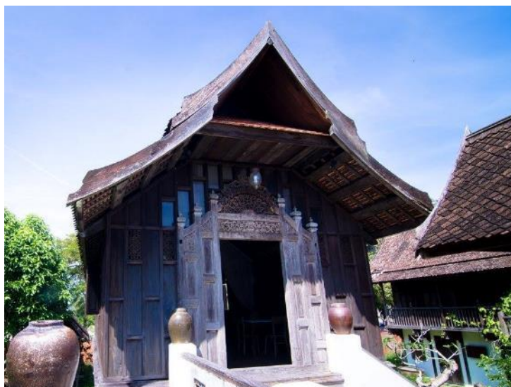
รูปที่ 33 หลังคาจั่วสามเหลี่ยม หรือ หลังคาแมงและ ที่มา: https://www.facebook.com/mohammad.chekob
