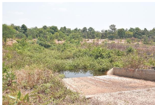
ภาพที่ 5-29 การสร้างฝายกั้นทางน้ำเชื่อมกุดกับแม่น้ำ
