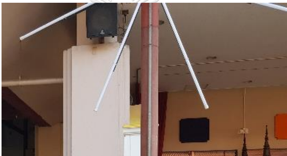
ภาพที่ 90 ลำโพงติดทุกมุมเสา เพื่อการประกาศ จัดทำโดย ผู้วิจัย (21 กุมภาพันธ์ 62)
