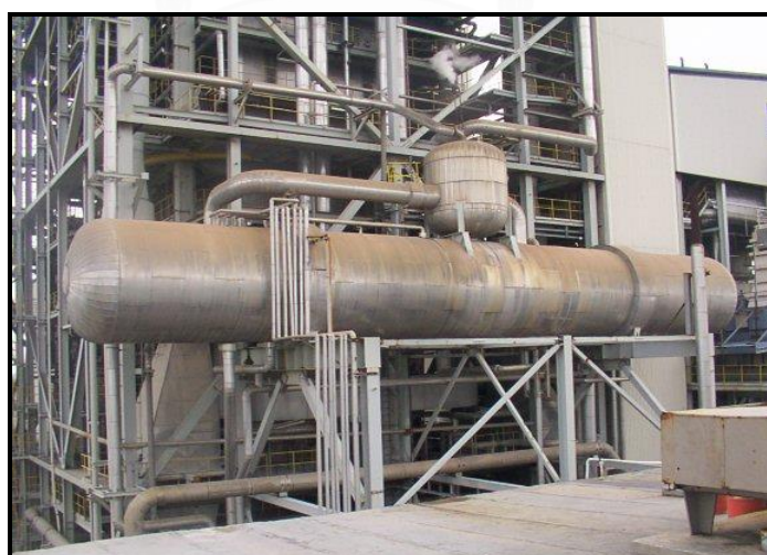
รูปที่ 1.9 ถังบรรจุน้ำป้อนสำหรับป้อนน้ำเข้าหม้อกำเนิดไอน้ำ
