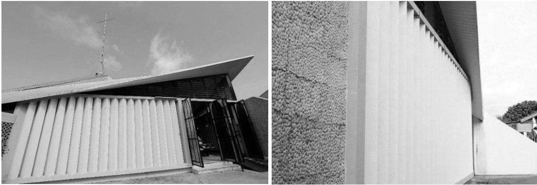
ภาพที่ 34 แสดงวัสดุผนังหินล้างและครีบบดตั้งคอนกรีตเสริมเหล็กโบสถ์แม่พระนิรมล จ.อุบลราชธานี
