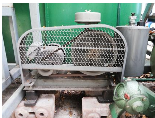
รูปที่ 15 เครื่องเติมอากาศ
