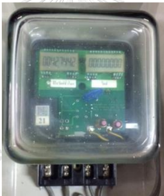
รูปที่ 7 มิเตอร์กำลังงานและพลังงานไฟฟ้า
