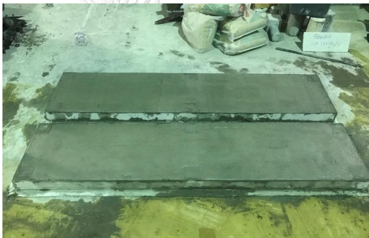
รูปที่ 4-16 กรอกคอนกรีตความหนาแน่นต่ำมากแล้วเสร็จ
