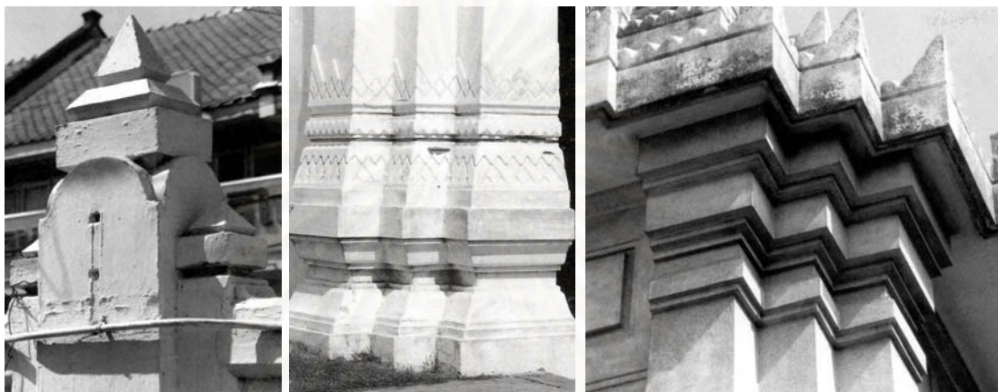
รายละเอียดองค์ประกอบทางสถาปัตยกรรมไทยเครื่องคอนกรีตของพระพรหมพิจิตร ที่ลดทอนจนเหลือเพียงทรวดทรงทางเรขาคณิต
