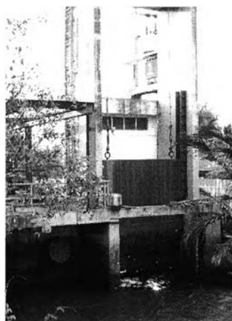
ภาพที่ 4: ประตูน้ำบริเวณปากคลองบางกระเจ้า
