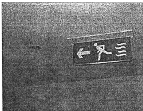
ภาพที่ 3.46 แสดงป้ายหนีไฟ หัวจ่ายสปริงเกอร์
