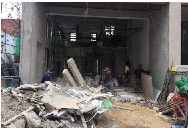
รูปที่ 1.2 กองของเสียจากการก่อสร้างภายในพื้นที่
