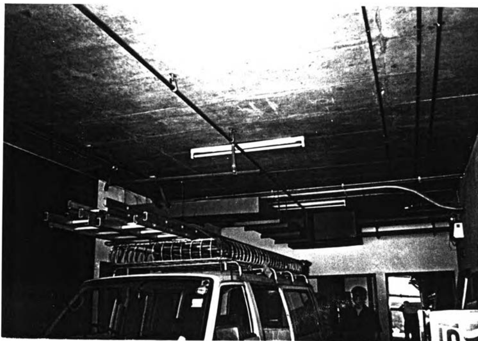
ภาพที่ 81 แสดงภาพถ่ายระบบป้องกันเพลิงไหม้(Sprinkler)โครงการ Century Height
