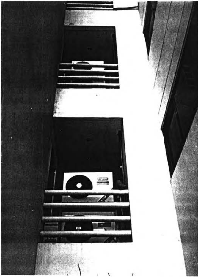
ภาพที่ 79 แสดงภาพถ่ายระบบปรับอากาศ(ชุดระบายความร้อน)โครงการ Century Height
