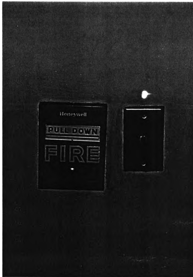
ภาพที่ 111 แสดงภาพถ่ายระบบป้องกันเพลิงไหม้(อุปกรณ์แจ้งเหตุ)โครงการ Richmond Palace
