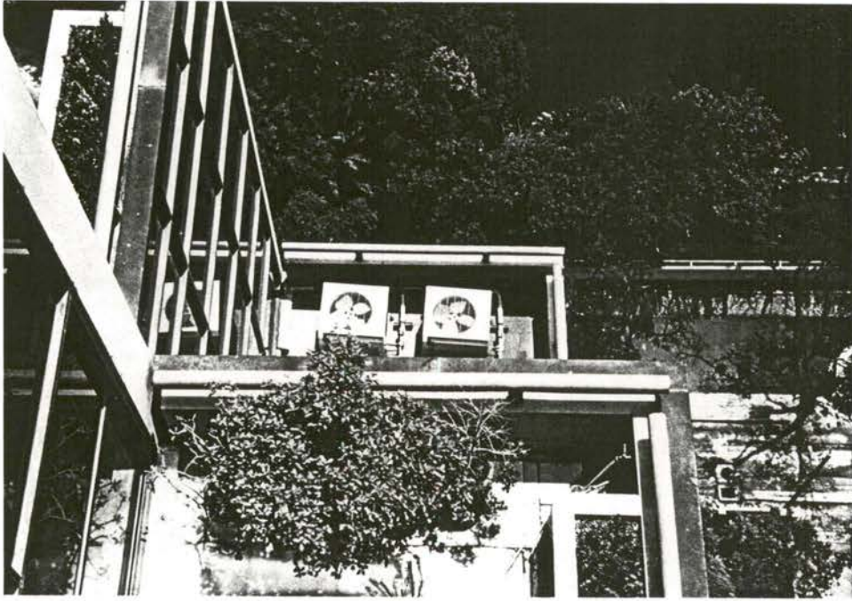
ภาพที่ 26 แสดงภาพถ่าย ระบบปรับอากาศ(ชุดระบายความร้อน)สมมติการเดิน
