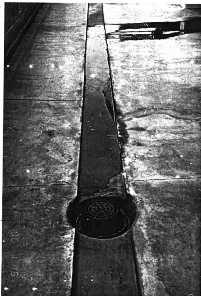
ภาพที่ 199 มีท่อและรางระบายน้ำที่เพียงพอและมีขนาดเหมาะสม
