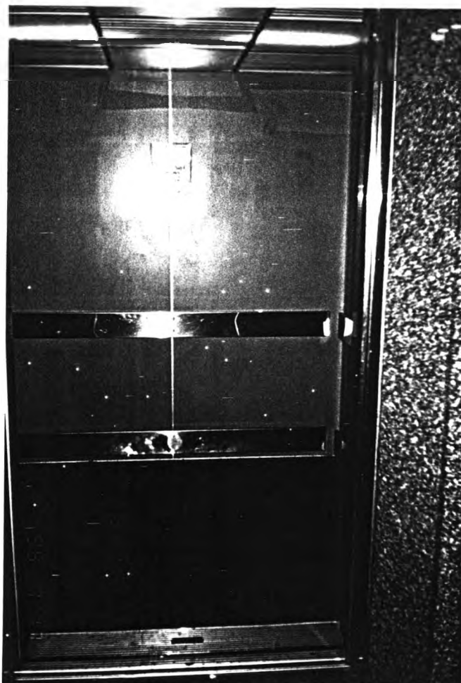
ภาพที่ 224 มีลิฟท์สำหรับขนของเฉพาะแยกจากลิฟท์โดยสาร
