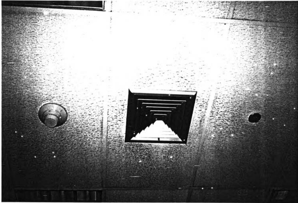
ภาพที่ 259 มีการติดตั้งระบบดับเพลิงอัตโนมัติหรือระบบอื่น ๆ ที่เทียบเท่าและทำงานเองโดยอัตโนมัติเมื่อเกิดไฟไหม้
