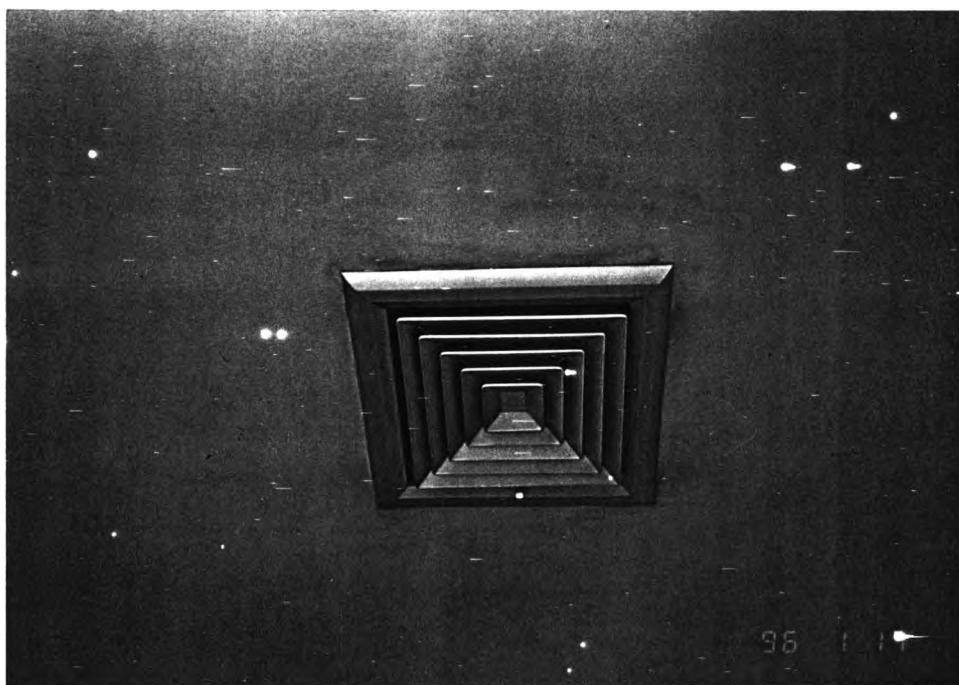
ภาพที่ 219 แผงจ่ายลมและแผงลมกลับของเครื่องปรับอากาศติดกับฝ้าเพดานฉาบเรียบหรือ แผ่นโลหะเพื่อสะดวกในการทำความสะอาดคราบฝุ่นที่ติดรอบ ๆ
