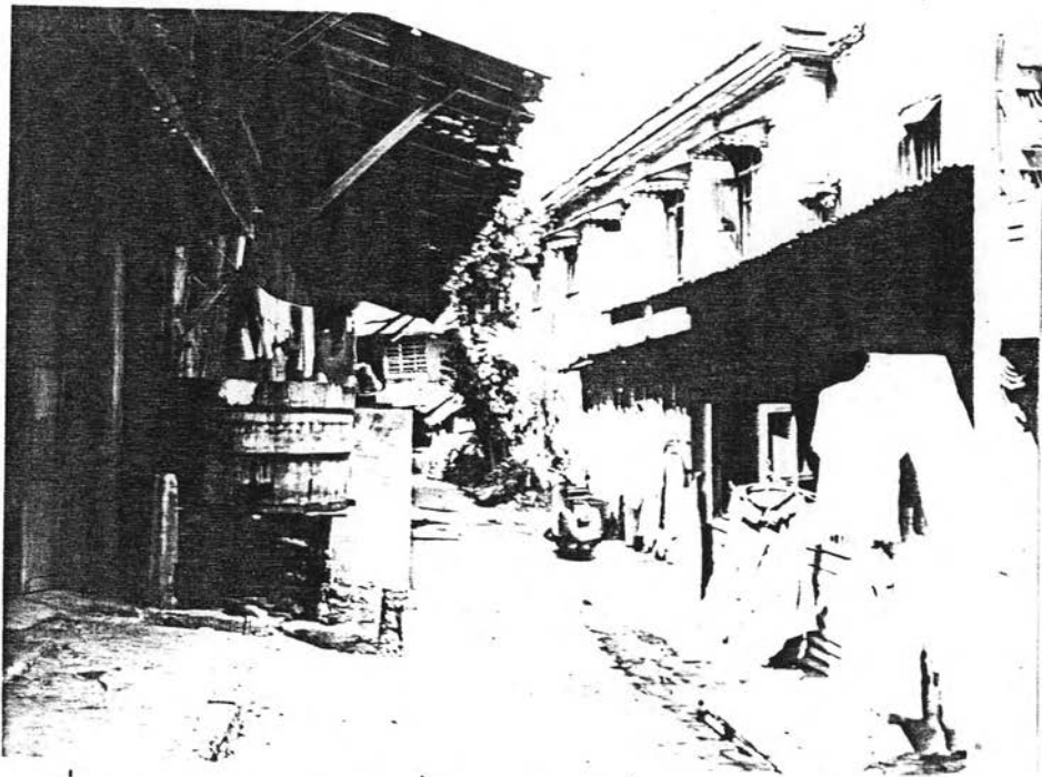
รูปที่ 5.7 อาคารคลังสินค้าที่มีสภาพเก่าแก่เสื่อมโทรม
